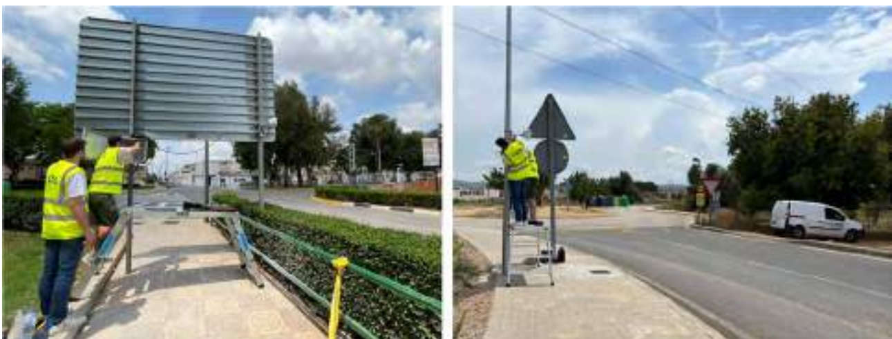
Ilustración 10. Instalación de los aforadores no intrusivos. Fuente: Elaboración propia.
